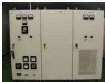
実習用受電設備
