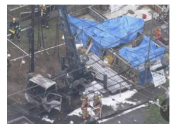
埋設されたアセチレン 容器の爆発事故 写真
