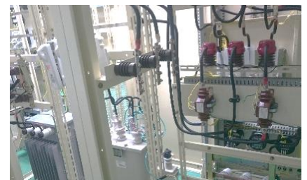
受電設備の2次側配線
