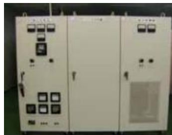
実習用受電設備
